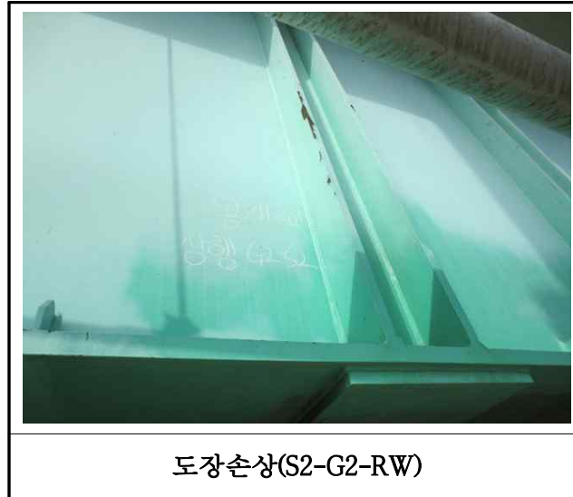
【사진 3.2.5】 강박스 거더 외부 손상현황(대구)
