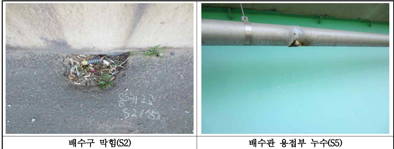
【사진 3.2.21】 배수시설 손상현황(대구)
