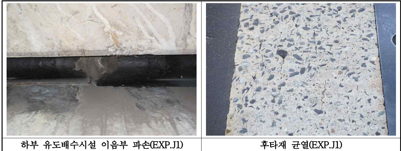
【사진 3.2.16】 신축이음장치 손상현황(대구)
