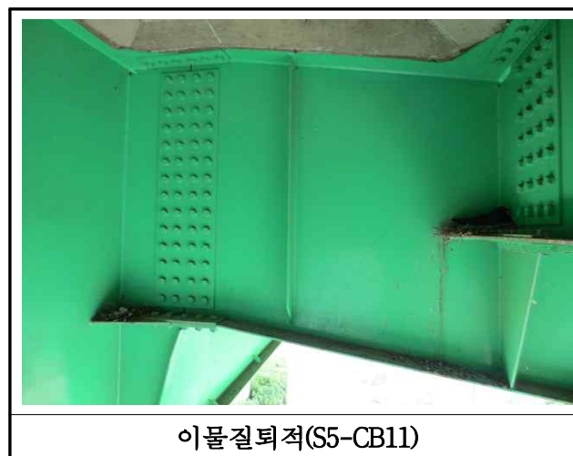
【사진 3.2.7】 가로보 및 세로보 손상현황(대구)
