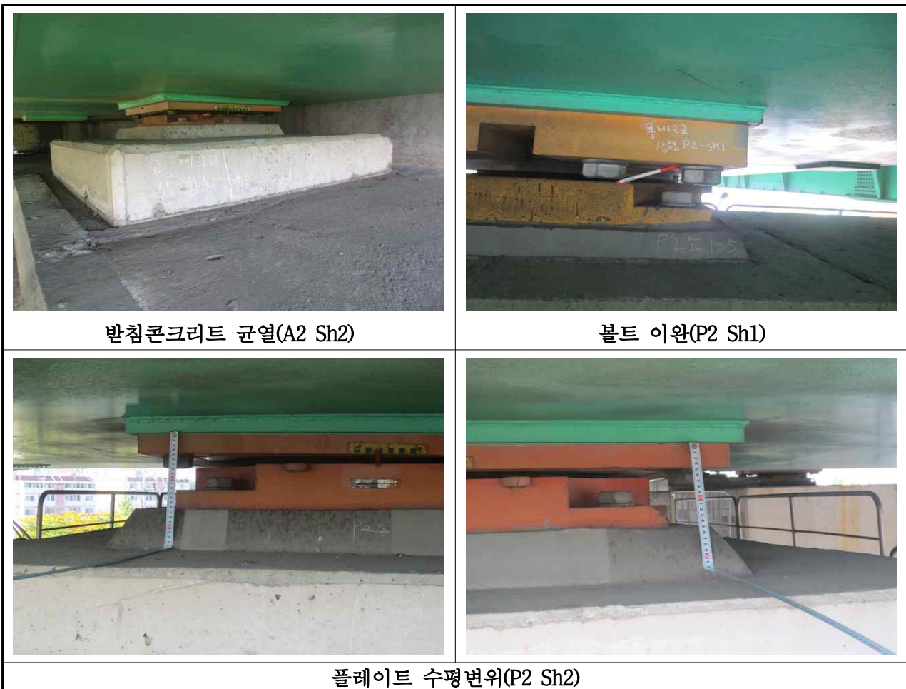
【사진 3.2.13】 교량받침 손상현황(대구)
