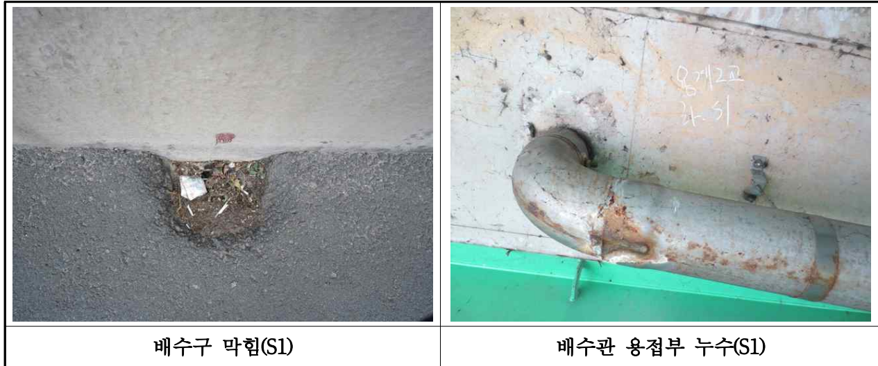
【사진 3.3.19】 배수시설 손상현황(부산)
