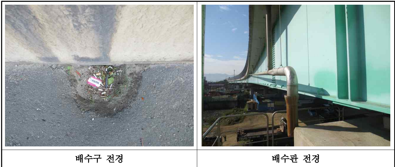
【사진 3.2.20】 배수구 및 배수관 전경(대구)
