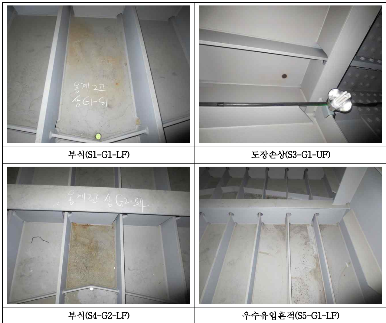
【사진 3.2.4】 강박스 거더 내부 손상현황(대구)
