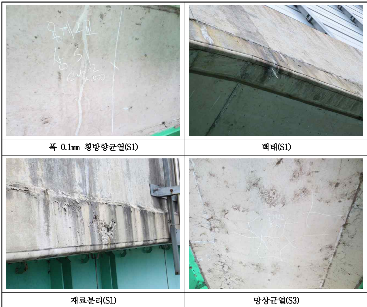
【사진 3.2.2】 바닥판 손상현황(대구)
